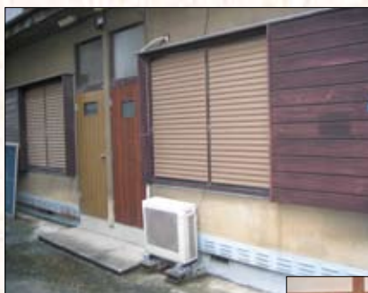
老朽化した外観。建物全体が古くて暗い印象を与えていた
